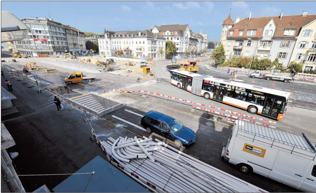
ZÜGIG GEHTS VORAN Noch laufen die Bauarbeiten auf Hochtouren, doch schon in wenigen Wochen kann der Platz wieder befahren werden. OLIVER MENGE
